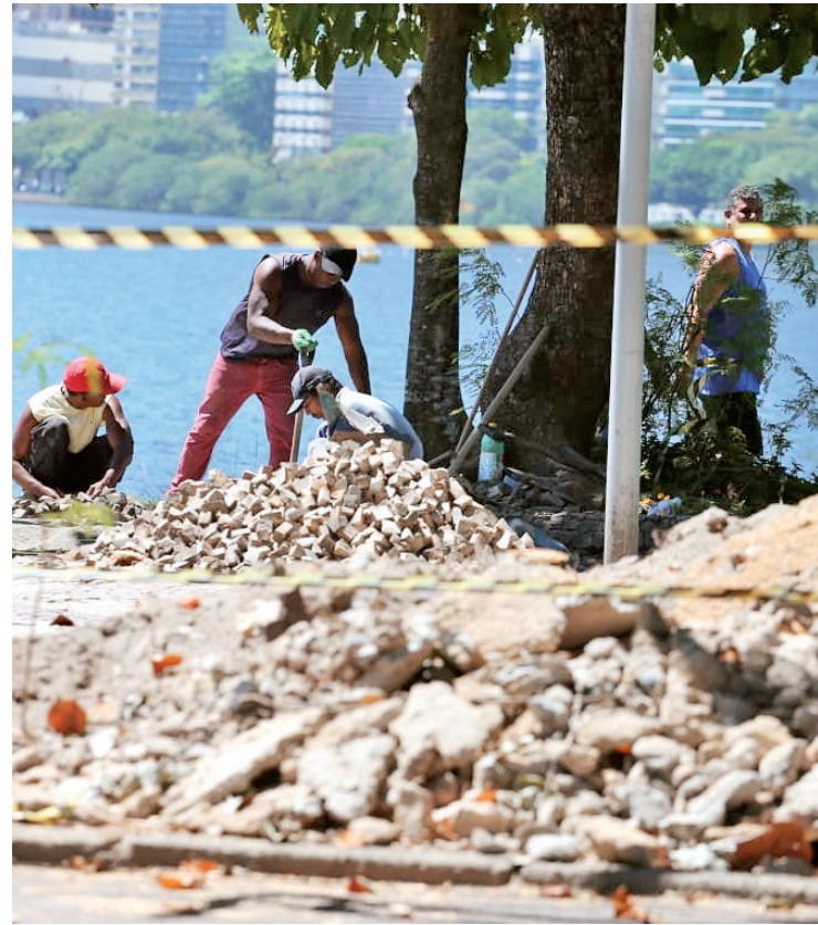
Construção ilegal de restaurante no Parque dos Patins, na Lagoa
