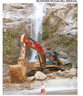
Queda de barreira na rodovia
